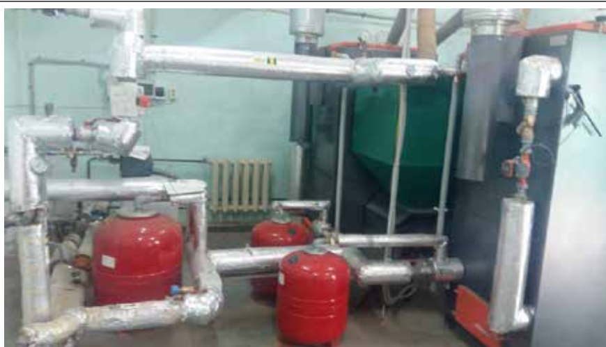
5.attēls. Apkures katls (Foto: Valda Gudynaitė–Franckevičienė)
